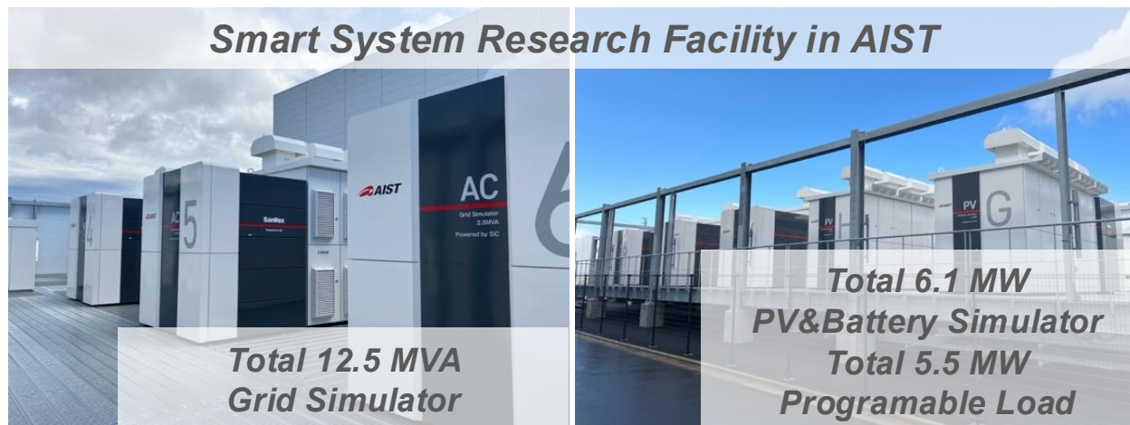
世界最大級の電源容量を誇るパワエレ開発・試験設備
